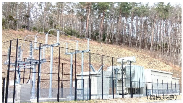
福島復興風力合同会社／阿武隈風力発電所 (田村市都路)
